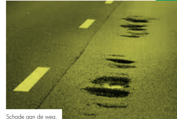
Schade aan de weg.
